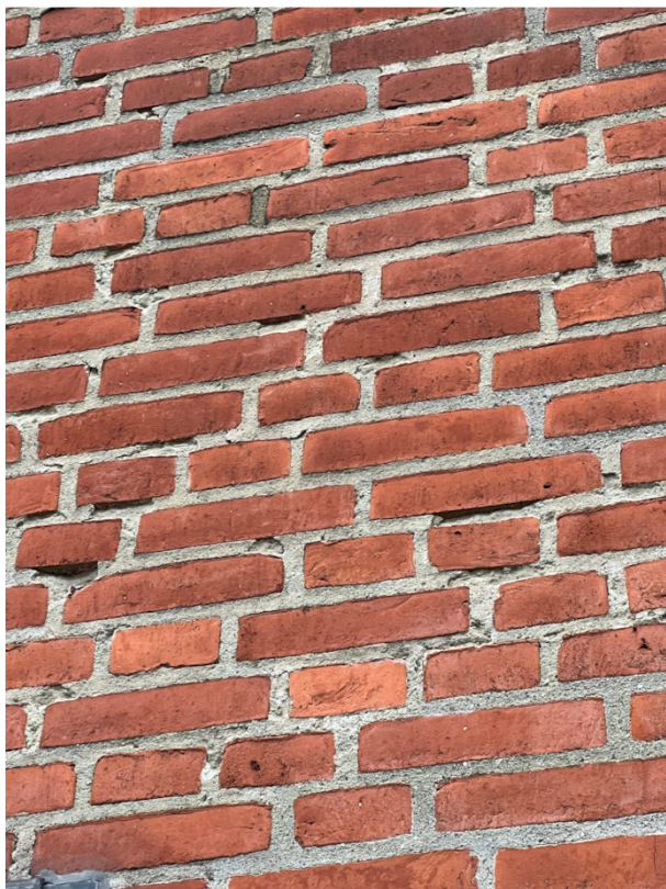
Der er enkelte områder med udfaldne fuger.
