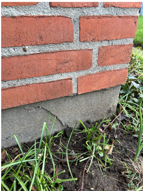
Revnedannelse i sokkelpudsens
