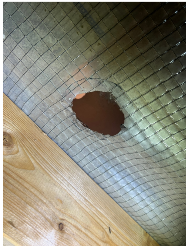
Undertaget fremstår enkelte steder med defekte ud-luftningsstudser
