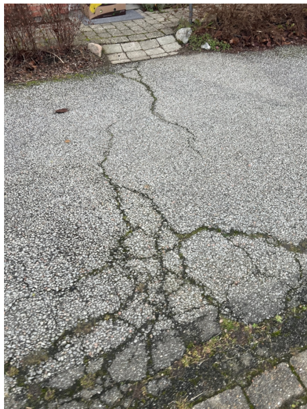
Revner i asfaltbelægningen
