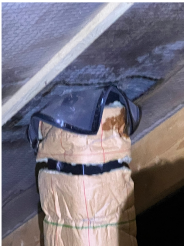
Undertaget fremstår enkelte steder med defekte undertagskraver ved gennembrydninger i undertaget.
